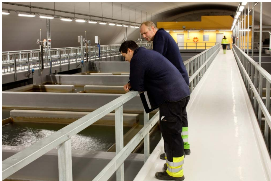
Oset vannbehandlingsanlegg. Foto: Vann- og avløpsetaten
